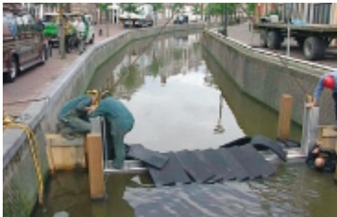
Bewegliche Sperre zum Trennen von sauberem und verschmutztem Wasser, Leeuwarden
